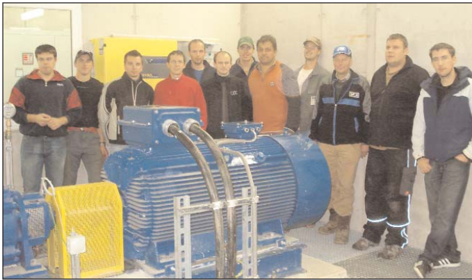
Sternstein Sessellift GmbH: Inbetriebnahme der neuen Beschneigungs-Anlage (Hydraulik: LENKO; Elektrotechnik: SCHUBERT Elektroanlagen)
