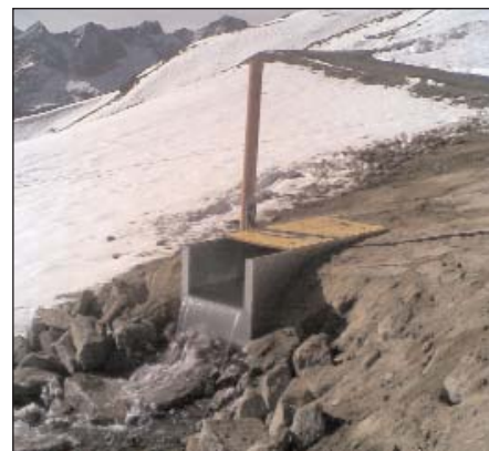
Wassermessung für die neue, schlagkräftige Beschneigungs-Anlage der Bergbahnen Kühtai in Tirol
