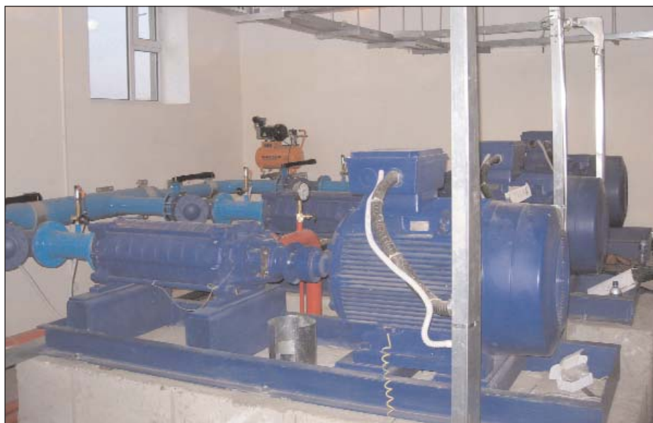
Die Pumpstation als das „Herz“ einer wirkungsvollen Beschneigungsanlage: Eine Gesamtleistung von 50 l/s und 375 kW - insgesamt wurden 14 km Luft- und Wasser-Leitungen verlegt.
