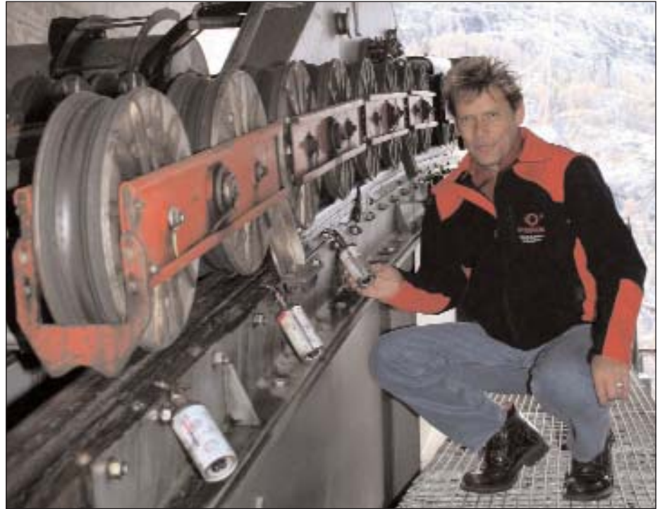
Daniel Kohler: Der Einsatz von Schmier Spendern bei Seilbahnen sorgt für eine effiziente und problemlose Schmierung der relevanten Anlagenteile in passender Dosierung und verlängert auf diese Weise Lebensdauer. Das spart Zeit und Geld
