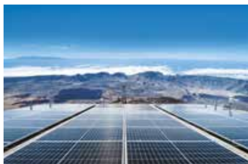
Die Standseilbahn Pico del Teide in Spanien nutzt das Hochleistungsenergiespeichersystem, das lokal erzeugte Energie speichert und so einen weitgehend energieautarken Betrieb ermöglicht. © DOPPELMAYR
