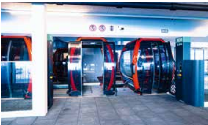
Die Talstation der Schwarzwandbahn ist auch dank baulicher Maßnahmen auf einen bedienerlosen Betrieb ausgelegt. © Doppelmayr
