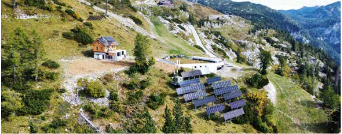
Die Testanlage am Loser (Steiermark) umfasst fünf verschiedene Modultypen. © Energie AG
