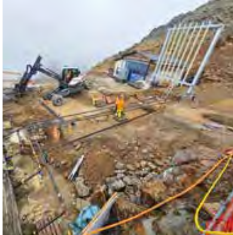
Installation eines Thermosiphons im Engadin St. Moritz in der Schweiz.
