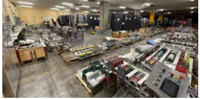
Sisag hat extra eine Halle angemietet, um die mehr als 60 Schaltschränke sowie weitere Komponenten vor der Montage zu testen.
