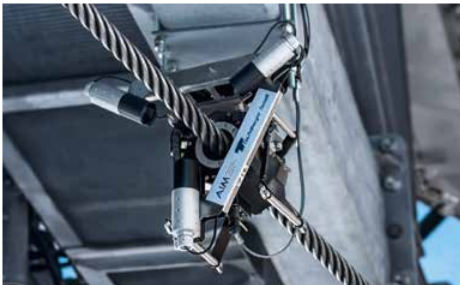
Das AIM-Kamerasystem an der 4er-Sesselbahn Findeln ist direkt in der MRT-Einheit integriert, was einen kombinierten Inspektionsablauf in einem kompakten Aufbau ermöglicht. © Raydn
