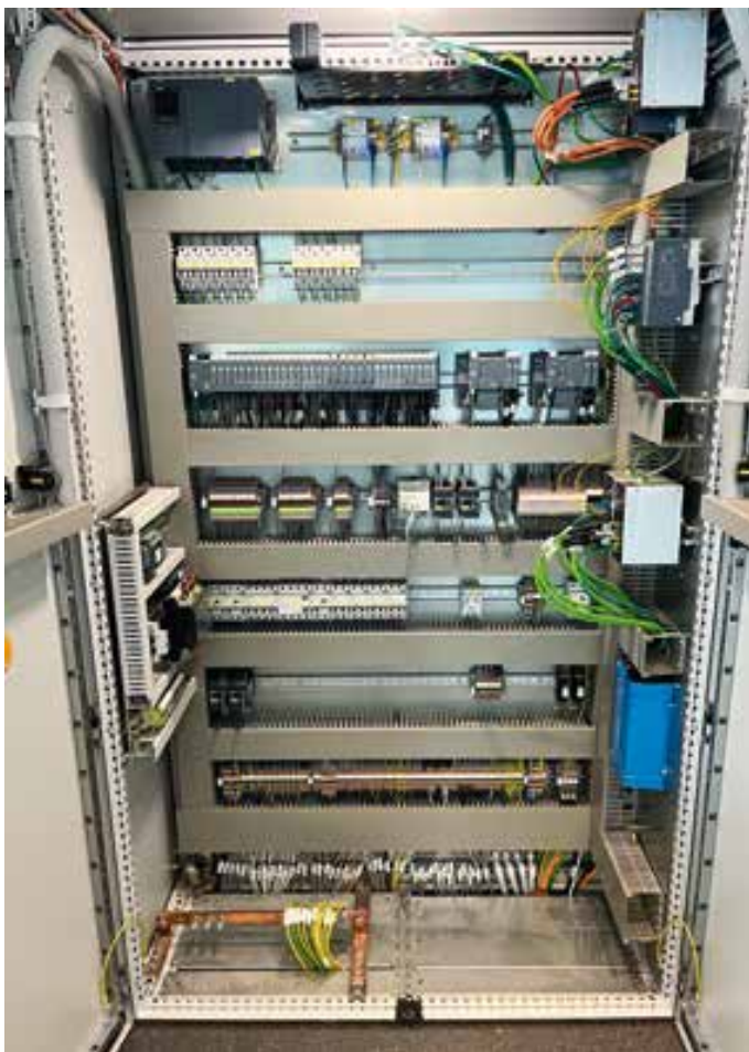
Steuerschrank der Standseilbahn Hallstatt mit moderner E-Technik.
