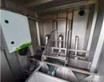
Mit Expertise geplante Messstellen sorgen für zuverlässige Ergebnisse und schaffen eine Basis für die weitere Planung. © cell GmbH
