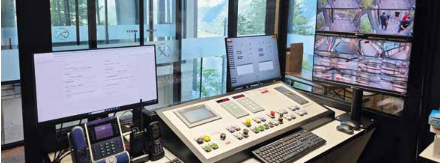
Das zentrale Steuerpult wird mit Betriebsdaten, VoIP Audi und hochauflösenden Videos versorgt. © FREY Austria
