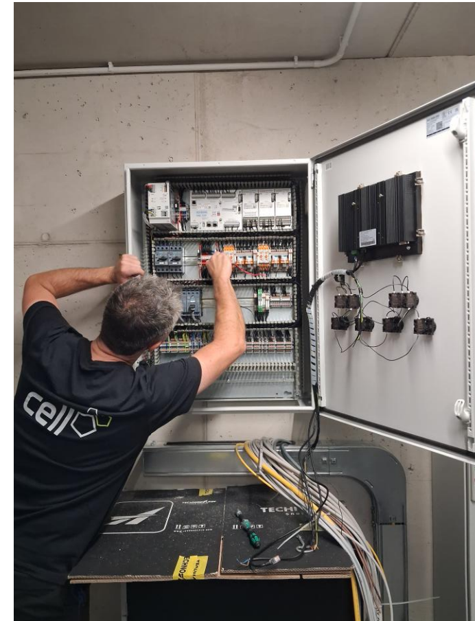
Vernetzte Fernwirkstationen: Erfassung, Weiterleitung, Steuerung
