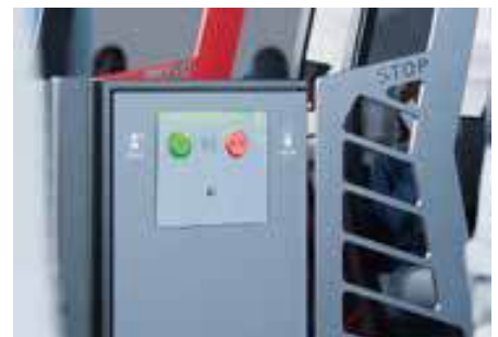
Die smarte Technologie LeitPilot für den autonomen Stationsbetrieb.
